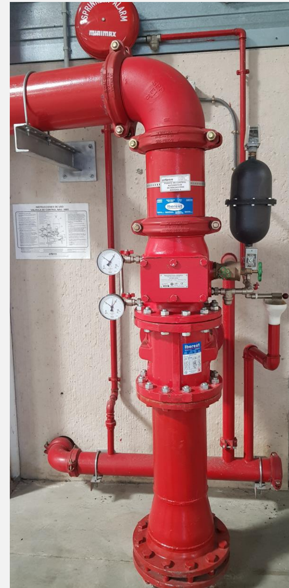
Sistema contra incendios
